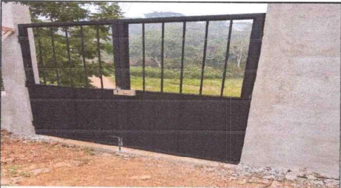
Foto 3: Instalación de Porton de la primera entrada para tener un mejor acceso de los niños al centro educativo.
