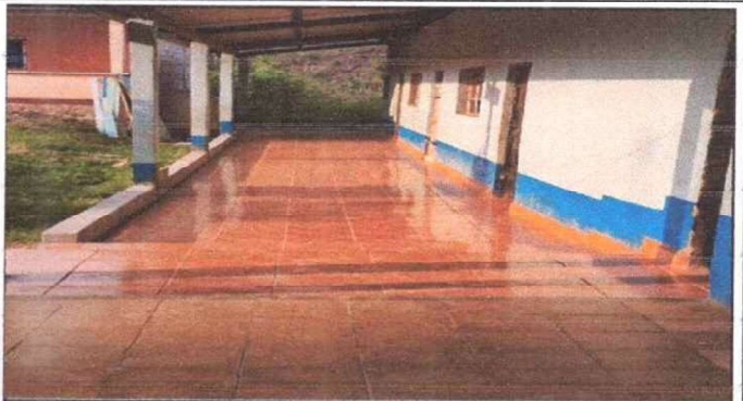
Foto 2: Se colocaron 167 metros cuadrados de piso cerámico en dos aulas y bodega del modulo numero uno del centro educativo.
